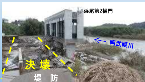
98.6k 左岸堤防決壊箇所(須賀川市)
