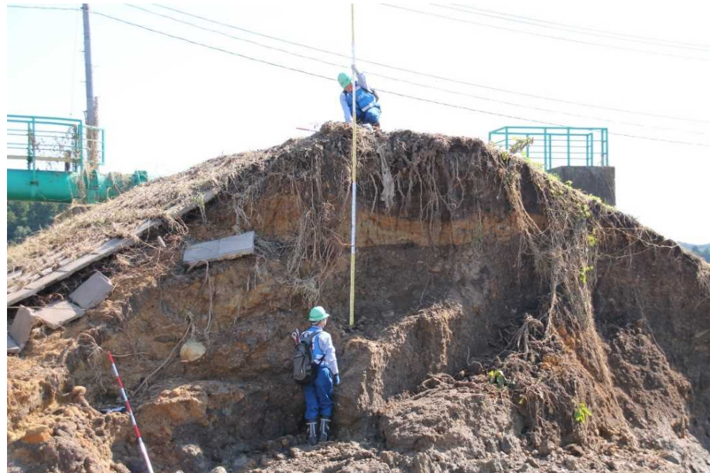
角田市坂津田上地内被災状況調査（10月16日撮影）
