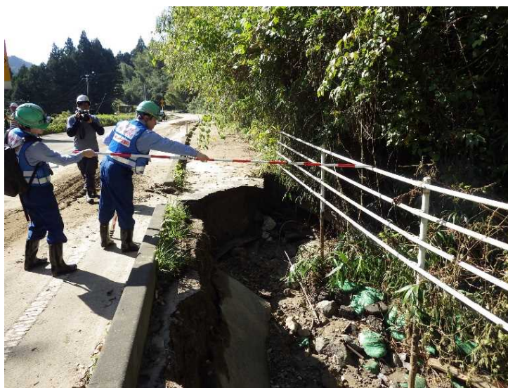
丸森町被災状況調査（10月17日撮影）
