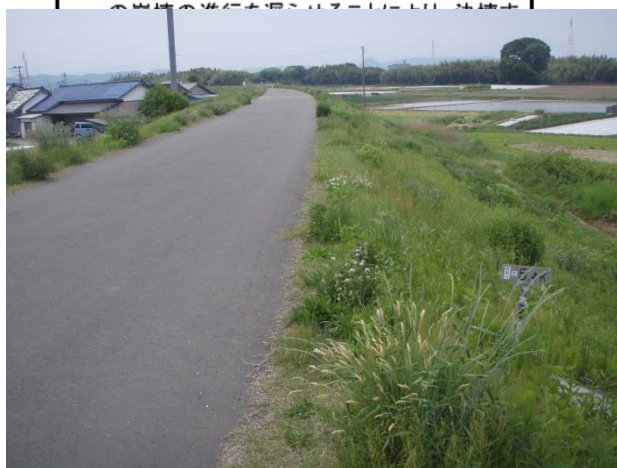
堤防天端の保護対策の保護対策(右岸 5.4k)
