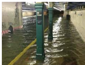
平成24年10月 ハリケーンサンディ 地下鉄駅の浸水
