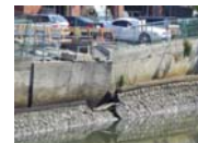
老朽化護岸の状況
