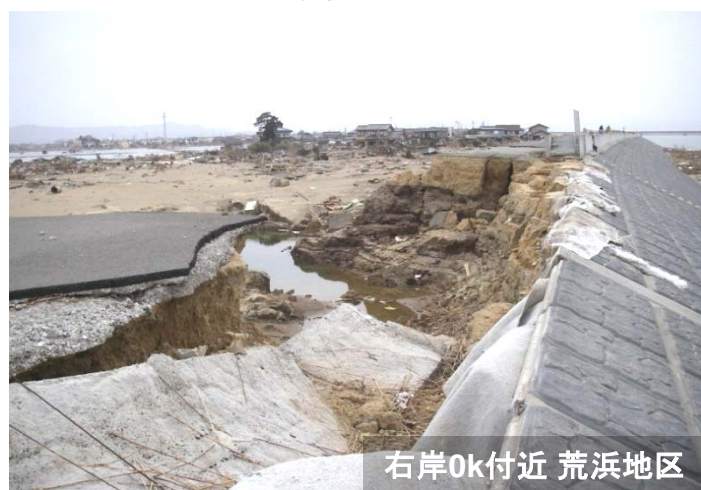
河口部堤防の被災状況
