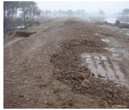
⑧堤内外洗掘(No.47付近)
