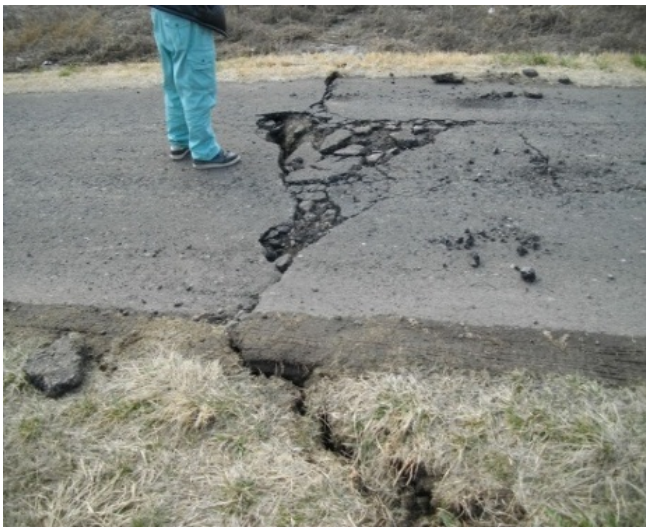
地震により堤防天端に亀裂
