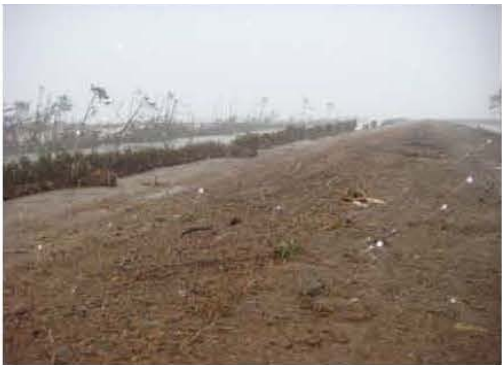
⑥サイクリング道土砂堆積(No.44付近)
