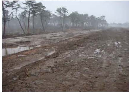
⑤堤内洗掘(No.42付近)
