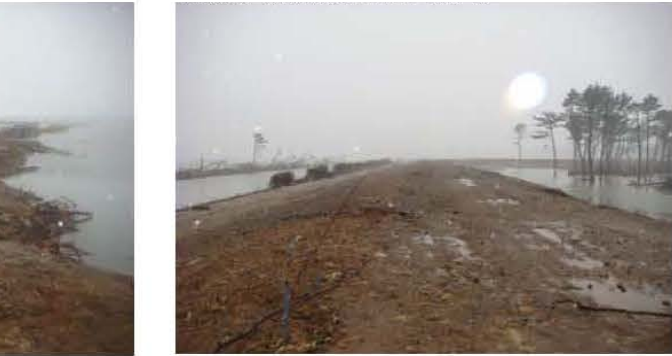
④堤内洗掘(No.40付近)
