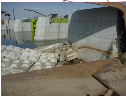
取付護岸洗掘
