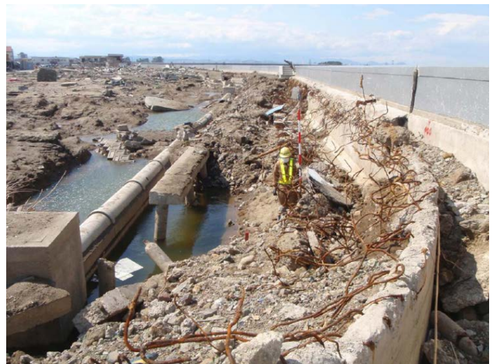
津波の越流により川裏部が侵食
