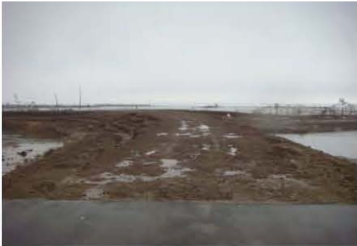
①堤内外法面洗掘状況(No.35付近)
