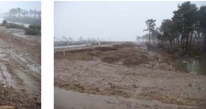
⑨堤内洗掘(No.48付近)
