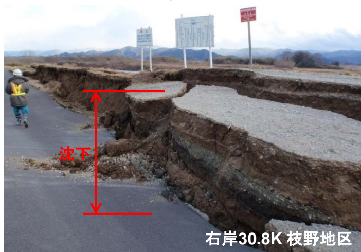
内陸部堤防の被災状況
