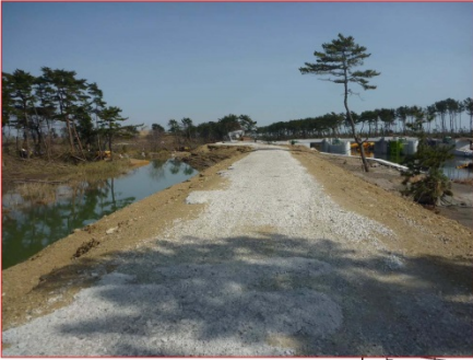
堤防堤内洗掘
