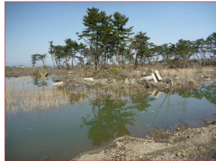
堤脚水路流失・散乱
