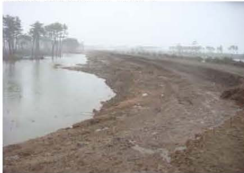
②堤内洗掘(No.36付近)
