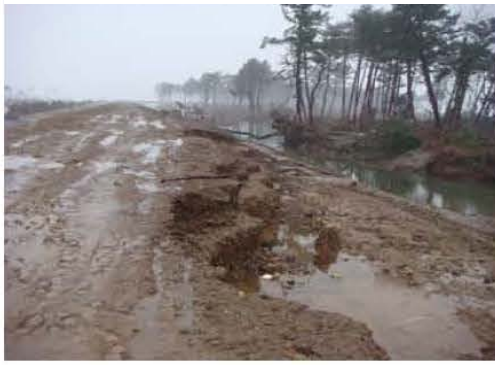
⑦堤内・坂路洗掘(No.46・2号坂路)
