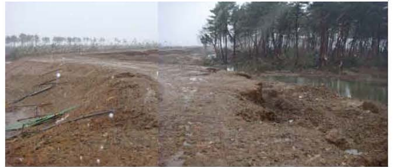
⑩堤内洗掘(No.49付近)
