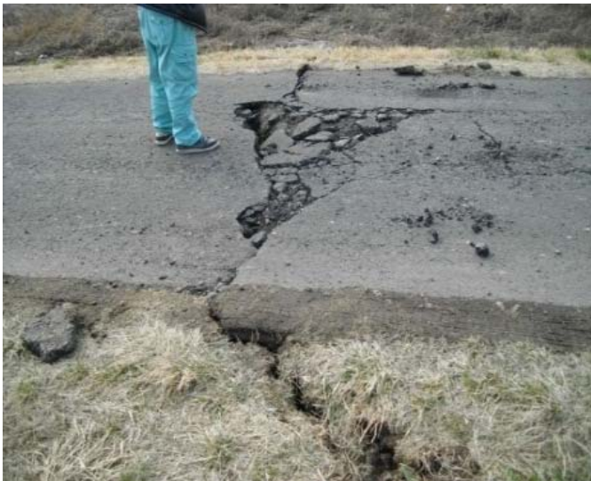
地震により堤防天端に亀裂
