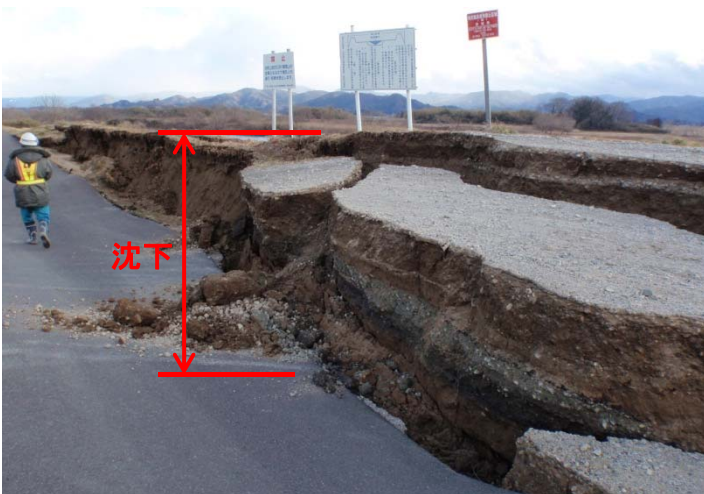
液状化により堤防が約2～3m沈下
