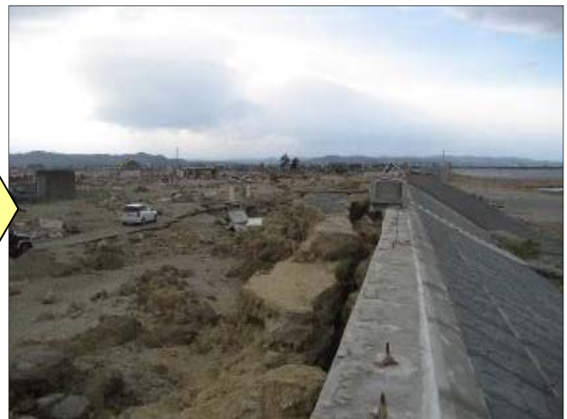
被災直後 平成23年4月
