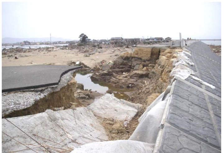
津波の越流により堤防の川裏部分が侵食
