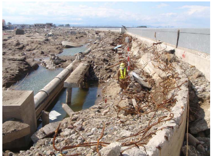
津波の越流により川裏部が侵食
