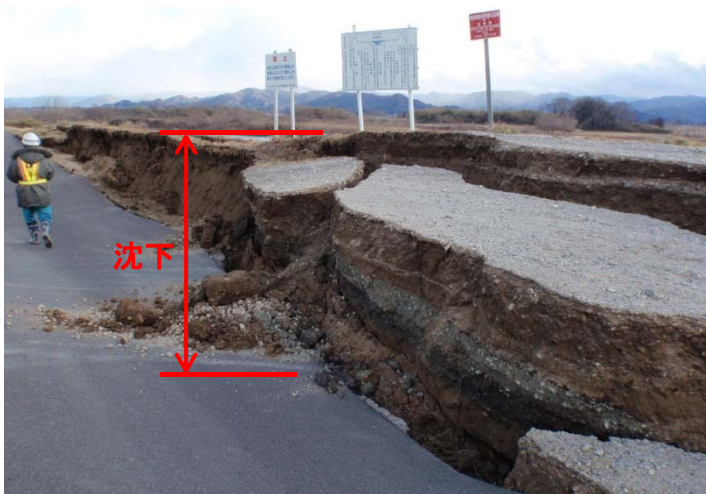
液状化により堤防が約2～3m沈下
