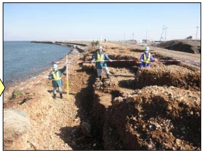
被災直後 平成23年3月
