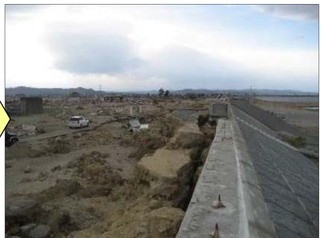
被災直後 平成23年4月
