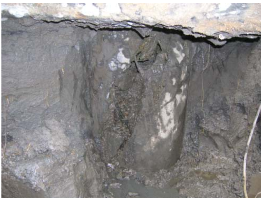
写真－29 基礎杭頭部の破断
