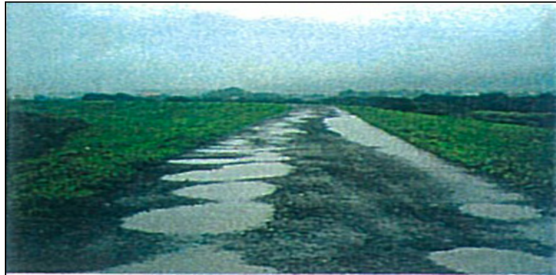
図 2.7 天端に生じた水たまり
