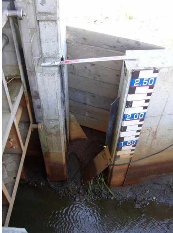
写真－27 門柱と翼壁部の開き 翼壁部が地震後に約 70cm 開いている。
