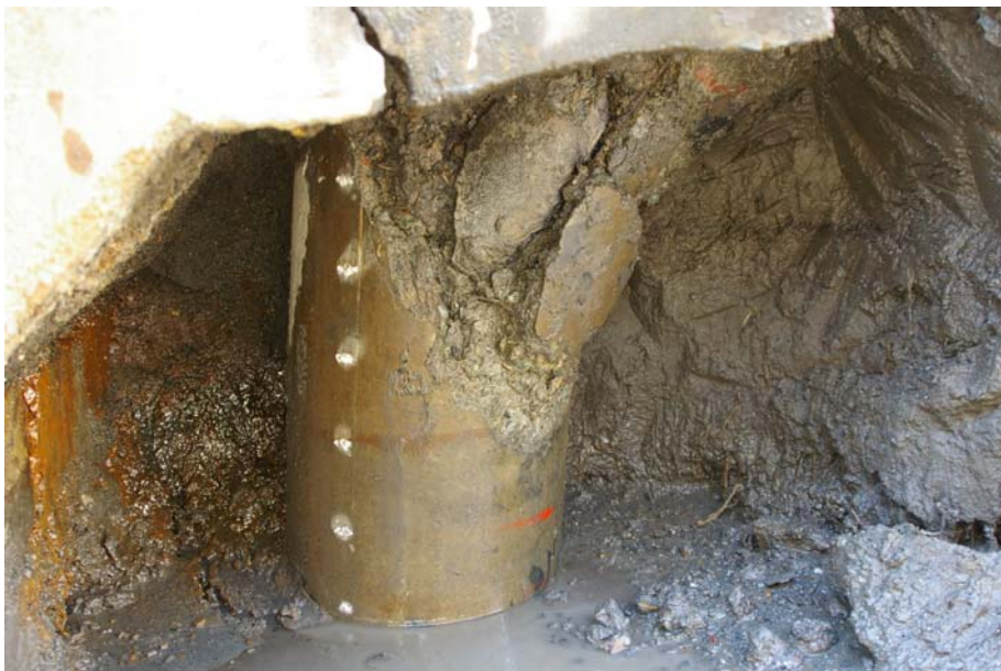
写真－28 基礎杭頭部の破断 函体の変形に伴い基礎杭頭部が破断している。
