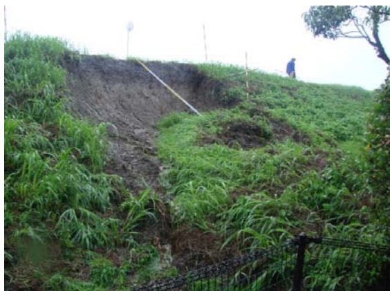
図 2.2 出水後の法崩れの状況
