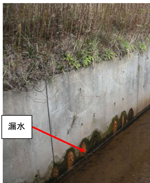
図 2.8 堤脚水路からの漏水
