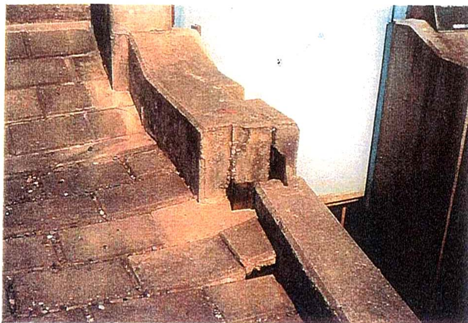
写真-3 函体と翼壁部の不同沈下（30cm）、目地の開き（3cm） 小段ブロック張の沈下（0～26cm） ブロックの浮き上がりの下は空洞となっている。
