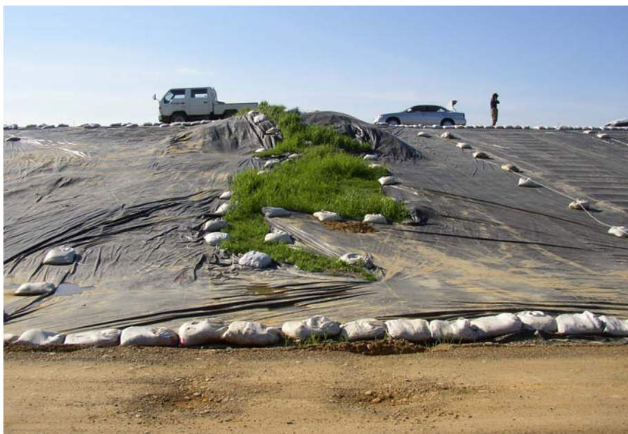
写真－25 函体直上の抜け上がり（堤内のり面）
