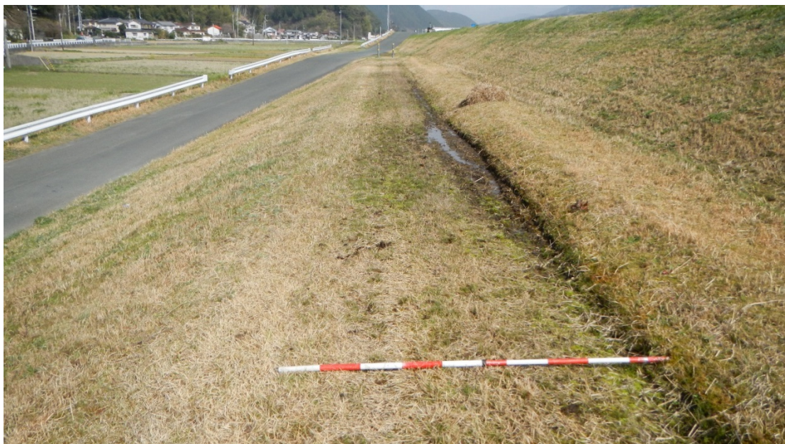
【小段逆勾配による雨水排水不良】
