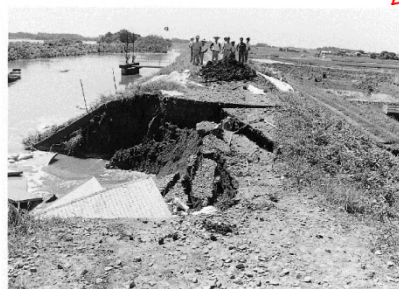
③ 川面側が陥没
