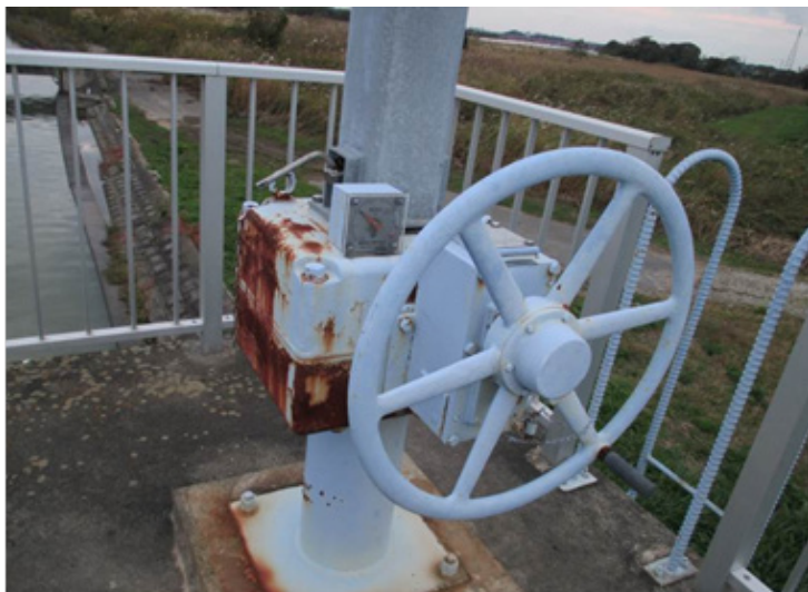
門扉巻上げ機(手動)
