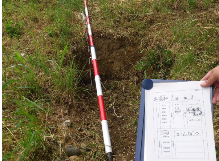
法面の陥没状況
