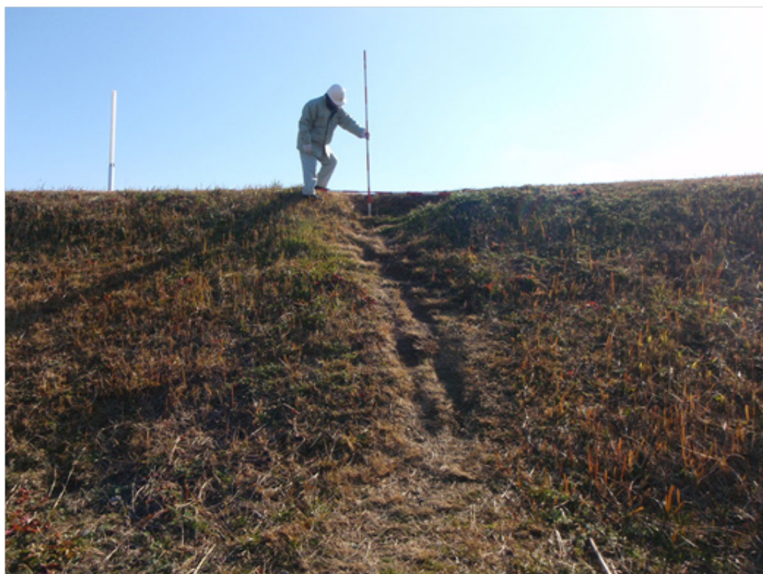
【堤防天端道路からの路面排水の集中による法面侵食】
