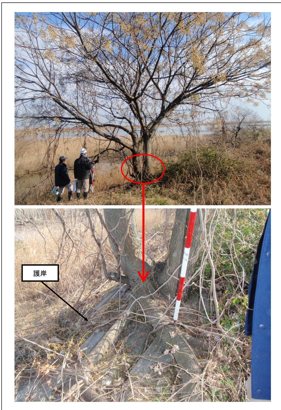
■ 低水護岸部に樹木が生えている状況
