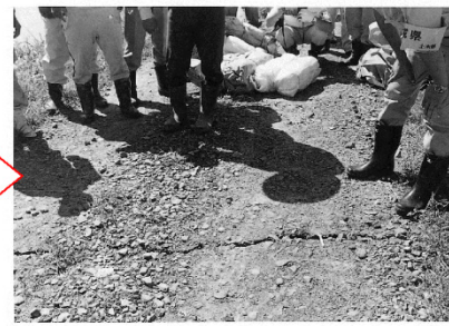
② 天端に横断方向の亀裂が発生
