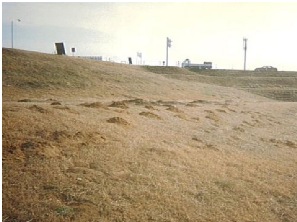
【堤防法面のモグラ塚と、地中のモグラの巣の状況】
