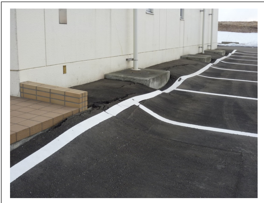
【近接構造物との段差等変状した状況】
