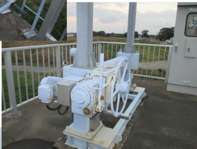
門扉巻上げ機(電動)
