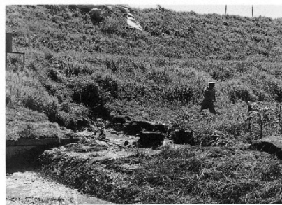
① 樋門の脇から漏水が発生
