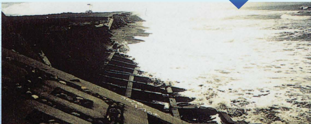
昭和63年に海岸堤防が被害を受けた。
