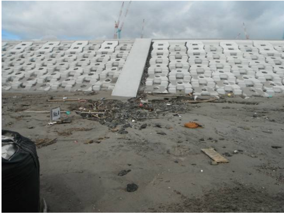
写真 4.1.3-6 吸出しによる陥没発生例
