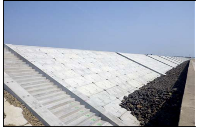
写真 4.1.2-67 表法尻保護工 (基礎割栗石敷設状況) 付属物設置工 (階段工設置完了状況)
