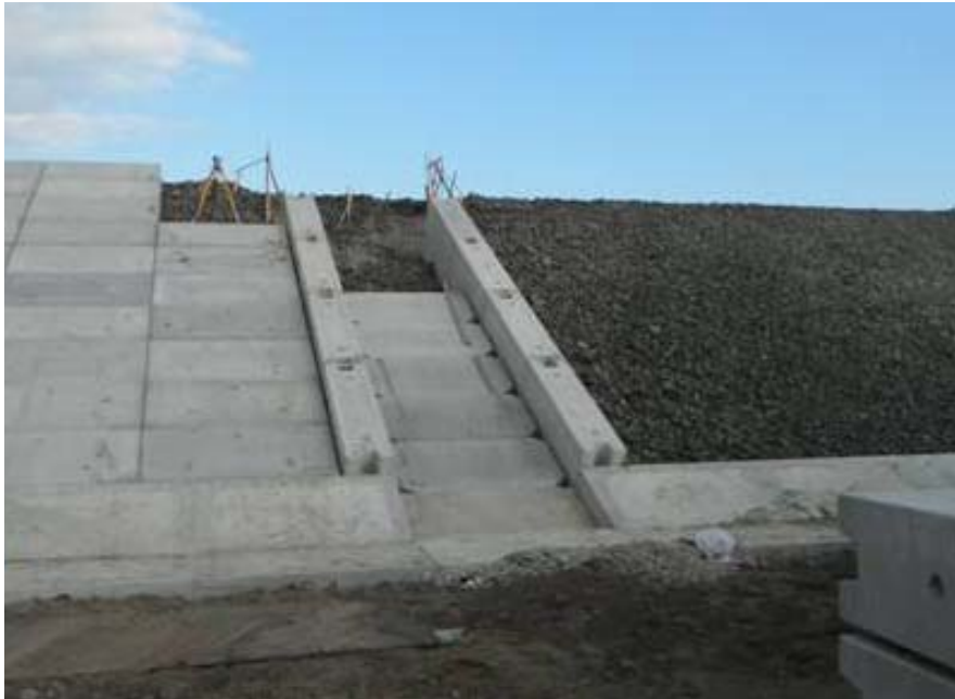
写真 4.1.6-10 ステップと背面が分離している階段ブロック例
