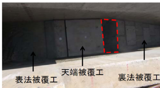
写真-8 法肩のブロックを天端被覆工と連結しないケース（高落差実験水路）
