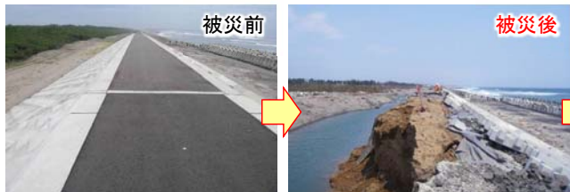
仙台湾南部海岸 蒲崎工区 海岸堤防の被災状況(宮城県岩沼市)
