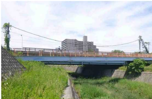
老朽化している橋（国道4号 仙台市太白区郡山）
