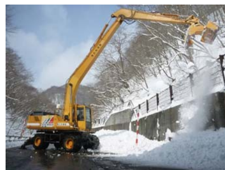
国道4号雪崩への対応 (H26. 2)
