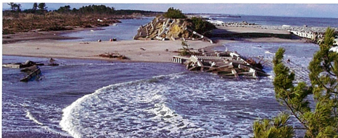
▲海岸堤防の被災状況（山元海岸）
