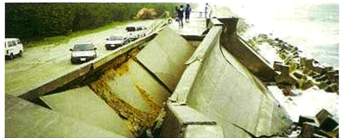
▲海岸侵食により堤防が被災（中浜海岸）
