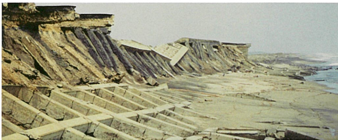
▲海岸侵食により堤防が被災（蒲崎海岸）
