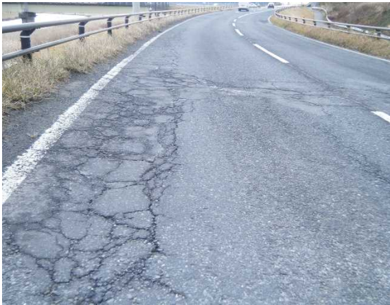
●舗装損傷状況
