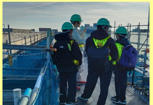
大規模な箱堤交差点立体化事業（仙台市若林区）の工事現場を見学
