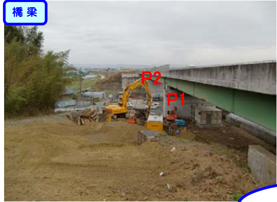
④ No.566から終点側を望む 上小松橋 全景 橋脚(P1 P2)
