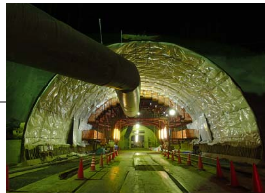
③ 坑口部を望む 志津川トンネル起点側(西工区) [防水工]
