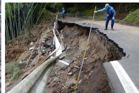
国道349号 路肩流出
