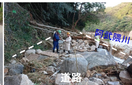
国道349号 土砂崩落・路肩流出
