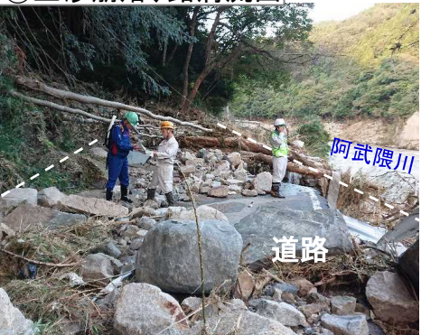
③ 土砂崩落、路肩流出
