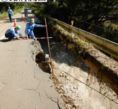
④ 路肩流出
