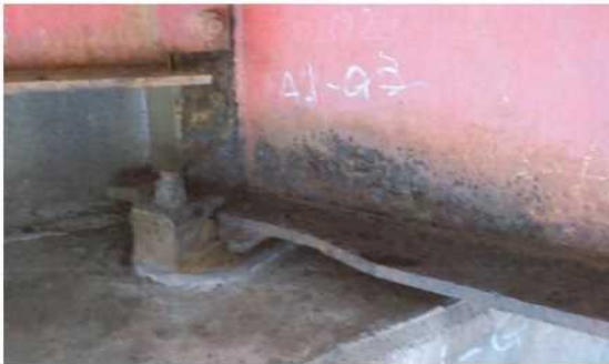
【損傷】主桁及び支承の腐食
