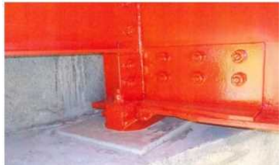
【対策】当て板補修、支承補修、塗装塗替等
