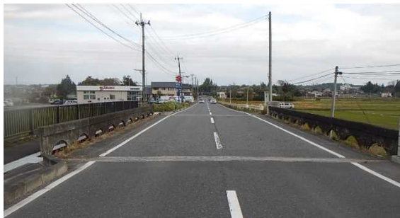
【損傷】伸縮装置、高欄の劣化
