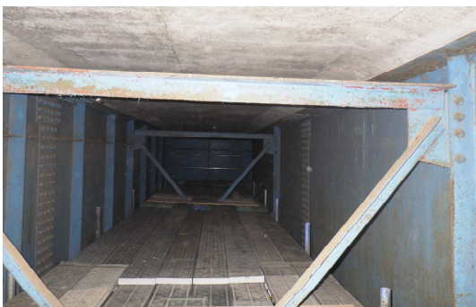
【損傷】腐食・変形・欠損
