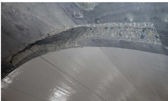
【損傷】打ち継ぎ目箇所の浮き・はく離
