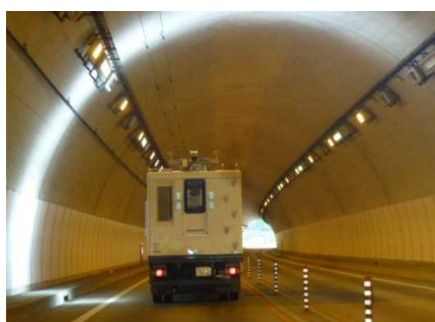
▲トンネルの変状写真を撮影する技術
