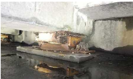
【損傷】支承の腐食
