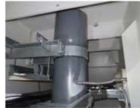
箱桁内部の貫通排水装置
