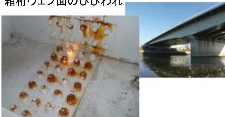
箱桁内のボルト部の腐食
