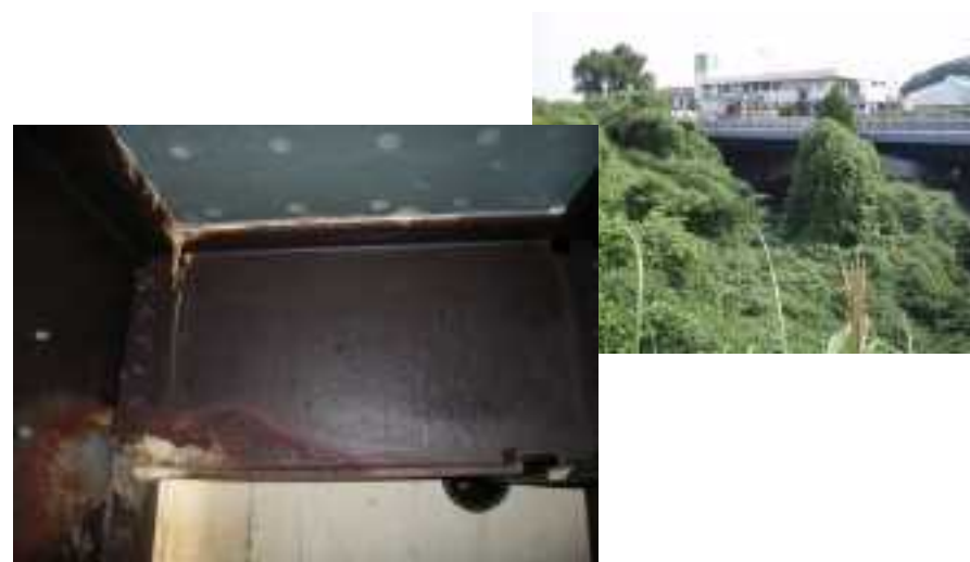
床版からの遊離石灰の析出
