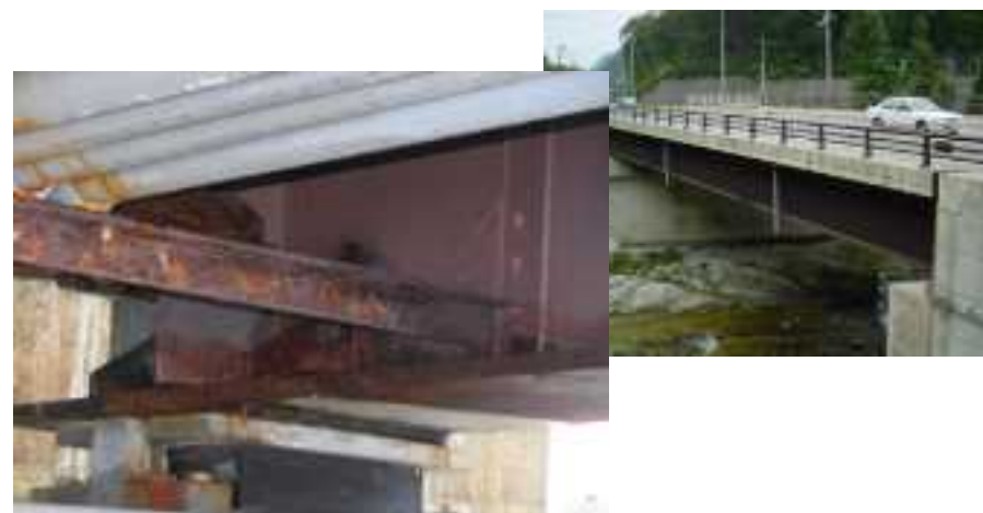
橋面排水の影響による腐食
