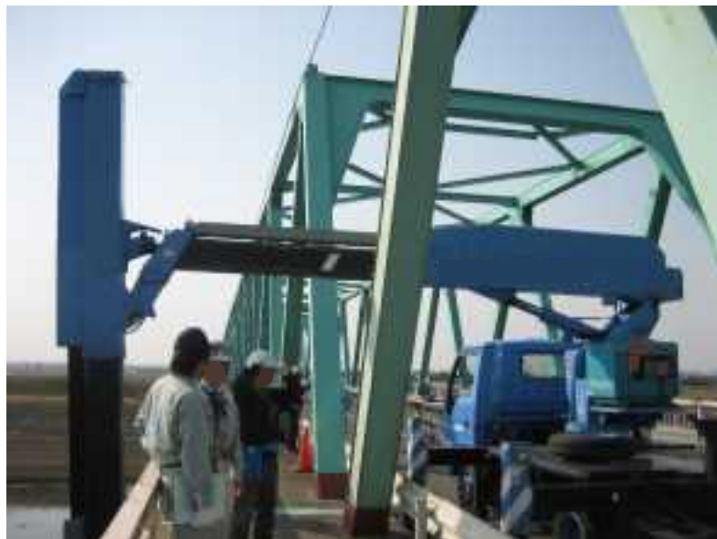
部材間の隙間を狙ってアームを通すのが手間であるトラス橋やアーチ橋
