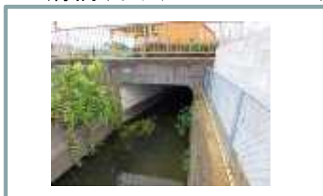
■ 溝橋(ボックスカルバート)
