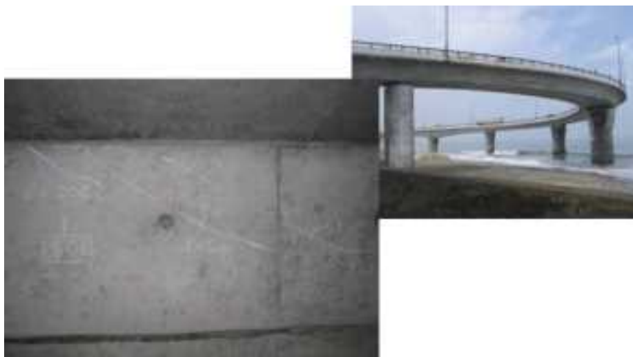
箱桁ウェブ面のひびわれ
