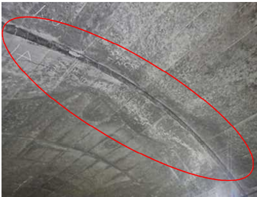
写真4-20 【損傷】 うき・はく離
