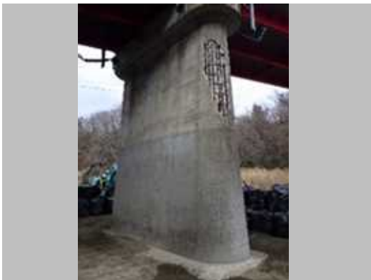
写真4-11 【損傷】 ひび割れ、剥離・鉄筋露出、うき
