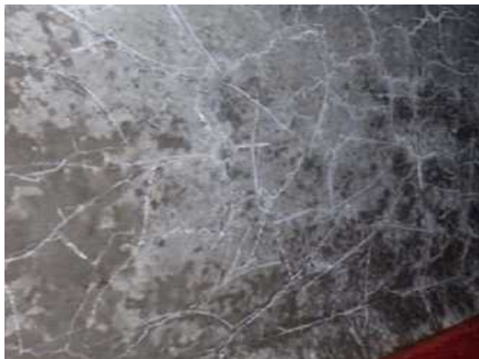
写真4-17 【損傷】 床版ひび割れ・漏水・遊離石灰
