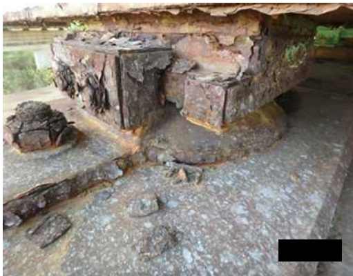
写真4-2 【損傷】支承の腐食
