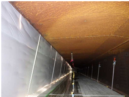
写真4-14 【損傷】 主桁・床版の防食機能の劣化
