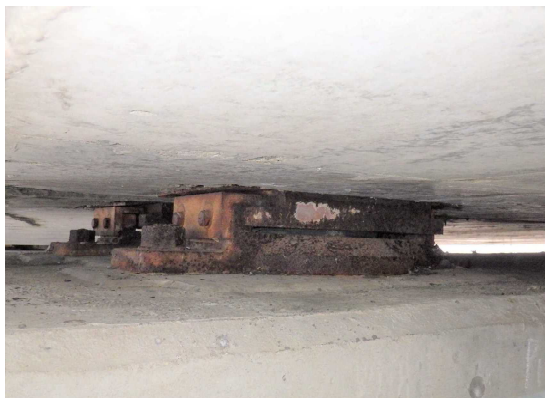
写真4-5 【損傷】支承の腐食
