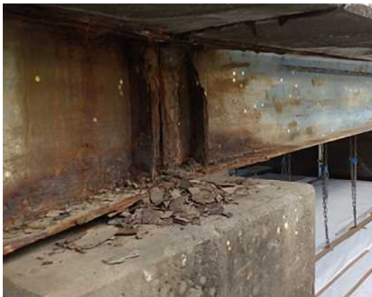
写真4-8 【損傷】 主桁の腐食、沓座モルタル欠損
