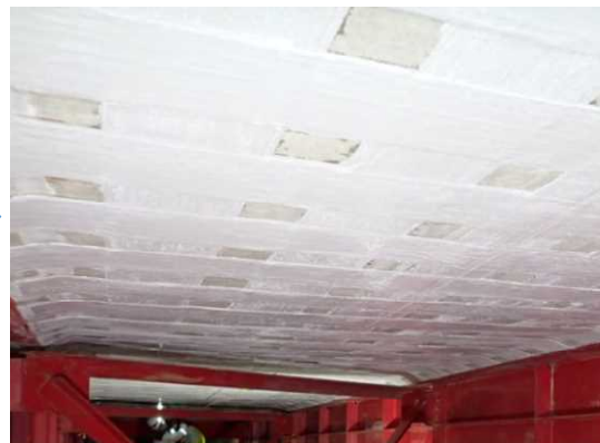
写真4-18 【対策】炭素繊維補強
