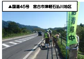
▲国道45号 宮古市津軽石弘川地区
