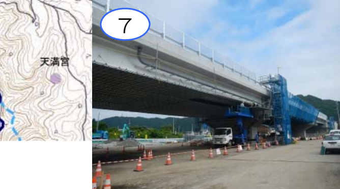
7 小本高架橋は、車両が通る床の部分の工事が完了し、足場の解体を行なっています。
