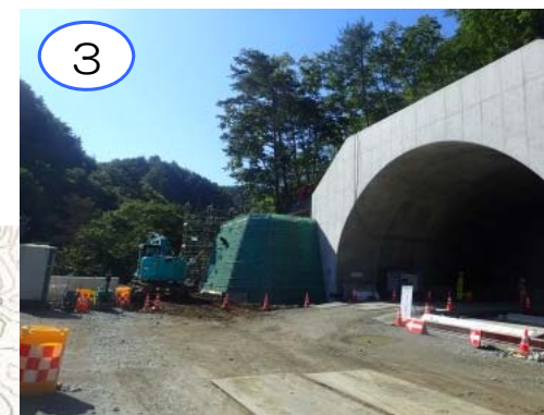
3 摂待第2トンネルでは、トンネルの掘削面をコンクリートで覆う覆工の工事が完成しました。終点側坑口においては、トンネルの周りの土を抑える壁を作っています。
