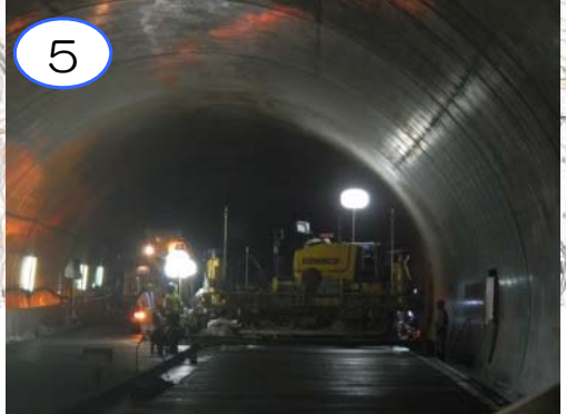
5 摂待第2トンネル内において、連続鉄筋コンクリート舗装の施工を行なっています。
