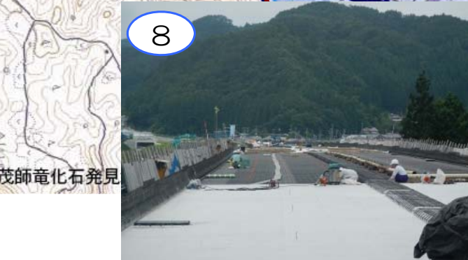
8 新小本大橋は、車両が通る床の部分の工事を進めています。
