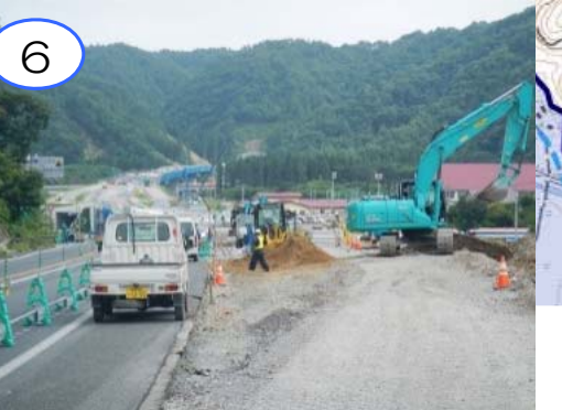
6 岩泉龍泉洞ICにおいて、舗装の土台となる本線とランプの路床の工事を進めています。
