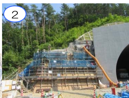
2 摂待第1トンネル終点側坑口において、トンネルの周りの土を抑える壁を作っています。
