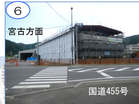
5 国道455号南側(宮古側)の補強土壁工事および気泡混合軽量盛土(FCB工法)工事を進めています。
