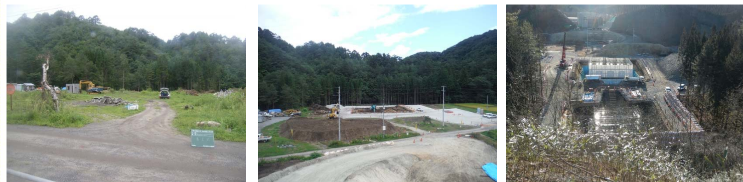
〔H26.8〕 工事着手前 〔H26.9〕 掘削の工事状況 〔H27.1〕 宮古側・橋台と橋脚の工事状況
