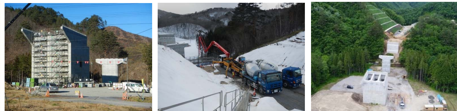
〔H27.12〕 宮古側・橋台と橋脚の完成 〔H30.1〕 久慈側・橋台の工事状況 〔H30.5〕 橋台と橋脚が完成
