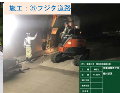
施工：⑧フジタ道路 椋内第1トンネル～田老第3トンネルにかけて舗装工事をすすめています。
