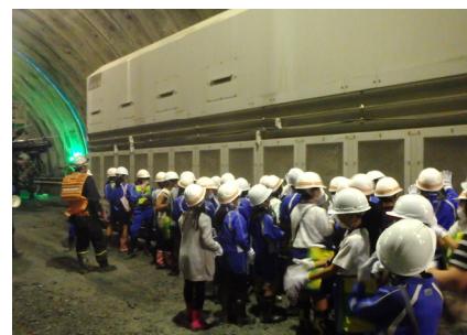
トンネル内のホコリを集める集塵機(しゅうじんき)
