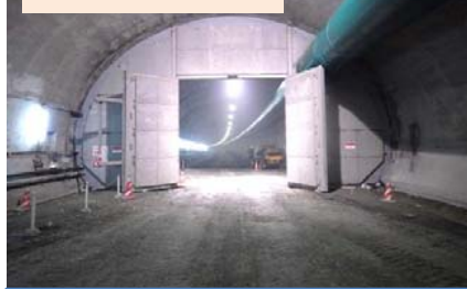
終点側内部の状況です。 現在、起点側494m 終点側1,180m の進捗です。
