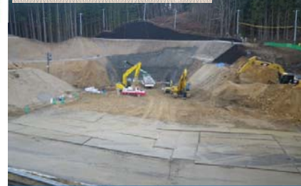
正面の場所から、田老第5トンネル を掘る工事がまもなく始まります。
