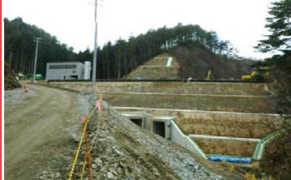
土を盛る工事もほぼ終わり、これ からトンネル工事が始まります。
