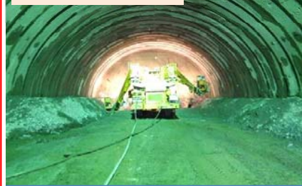
田老第1トンネル内部の作業してい る状況です。 現在、55mの進捗です。
