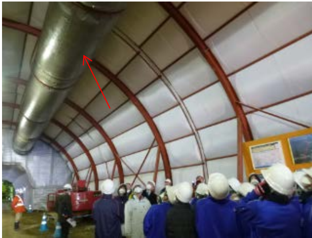
▲天井にある大きなパイプは、トンネル内に新鮮な空気を取り入れるためのものです
