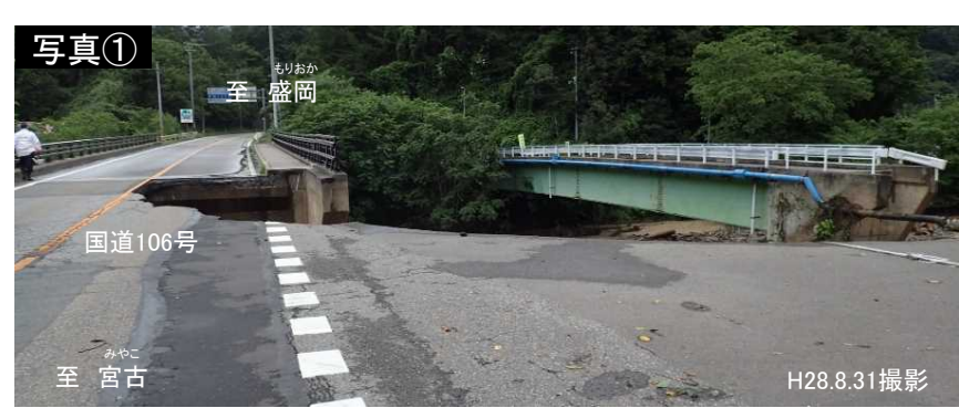
《平成28年8月台風10号被災状況》
