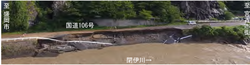
▲国道106号の決壊状況（平成28年8月台風10号災害）
