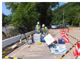
▲国道455号 乙茂 Ku-SAT設置状況
