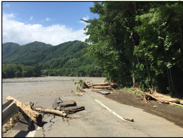
道路崩壊箇所
