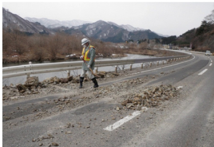
▲落石による通行障害
