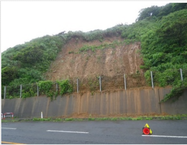
令和6年7月25日からの前線に伴う大雨による被災状況
