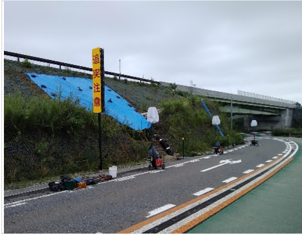
土のう設置による押さえ盛土、ブルーシートによる養生
