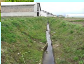
水路側壁の倒壊
