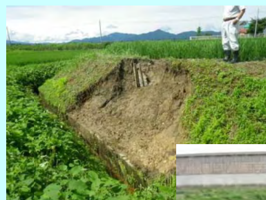
水路法面の崩壊
