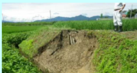
水路法面の崩壊
