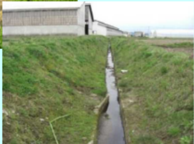
水路側壁の倒壊
