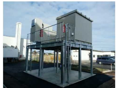
約2.5mの架台の上に設置した 非常用電源装置
