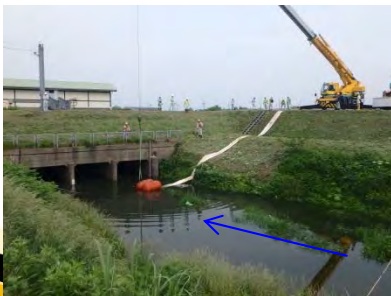
▲上流側ポンプ
