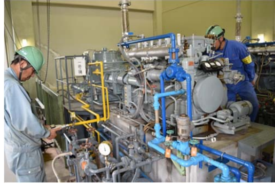
排水機場の定期点検
