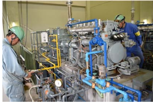
排水機場の定期点検
