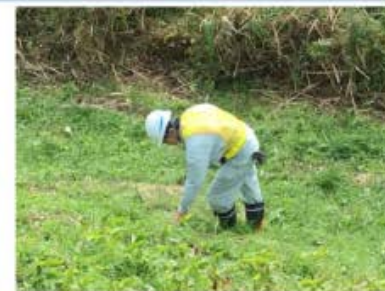
▲陥没付近の目視点検
