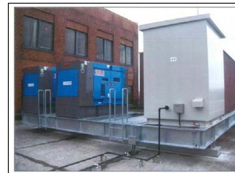
▲発電機、油庫設置完了
