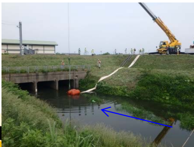
▲上流側ポンプ
