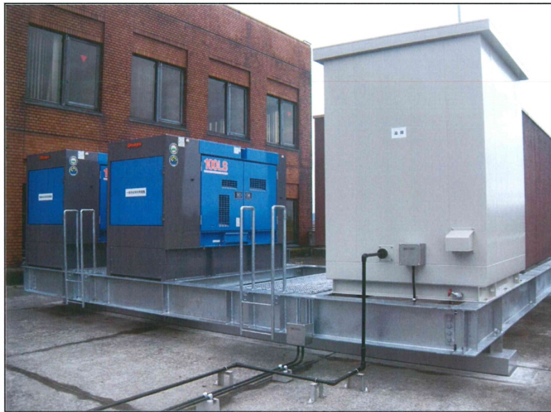
発電機、油庫設置完了
