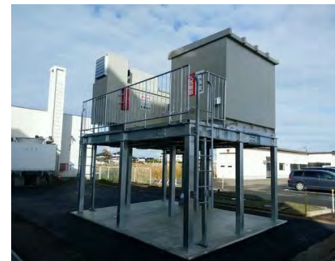
▲発電機設置状況
