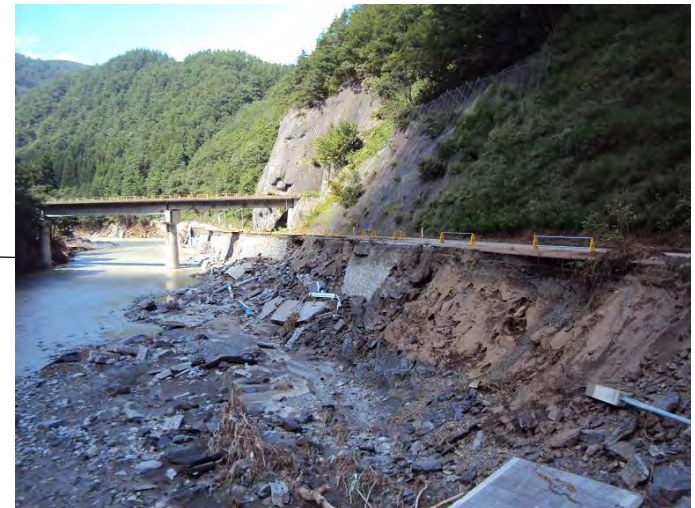
国道455号の道路被害状況(二升石地区)
