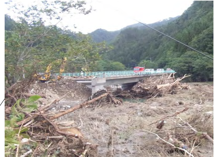
橋梁被害状況(乙茂地区)
