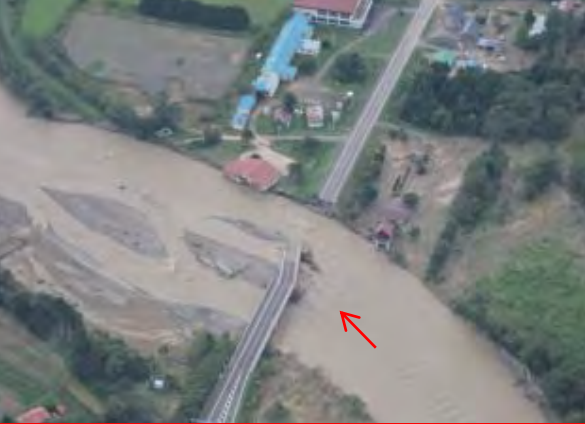
沙流川水系沙流川の被害状況 (日高町)
